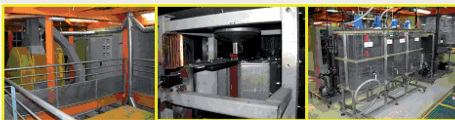
Concasseur, séparateur magnétique, station de traitement d'eau
